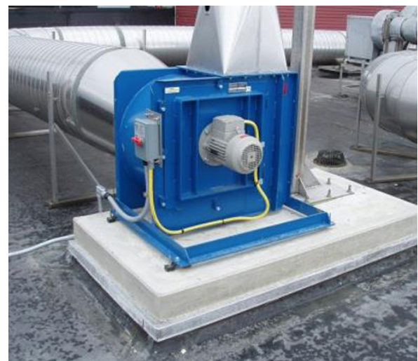
Ventilateur placé sur le toit.
